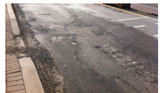
그림 2. 기후변화에 의한 도로파손
